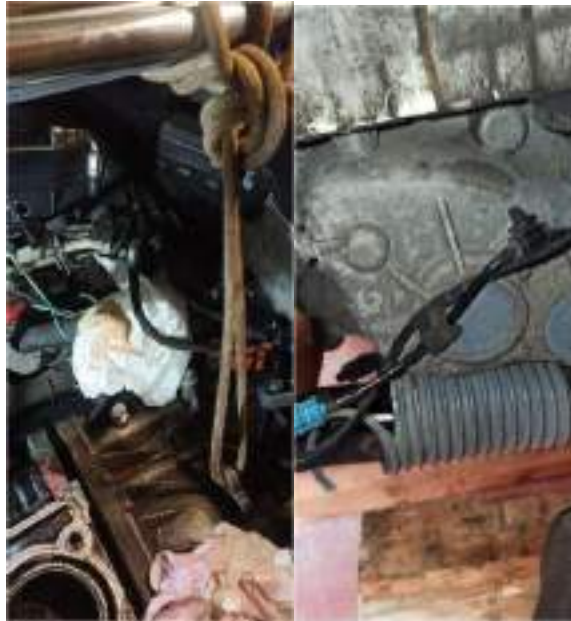
Ilustración 48: Caja de cambios sujeta a soporte metálico y ya desplazada.
